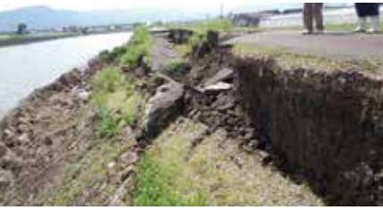
大鞆川堤防崩壊する(4月16日)
