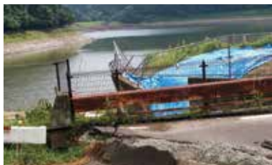
大切畑ダム堰堤の亀裂現場(8月3日)
