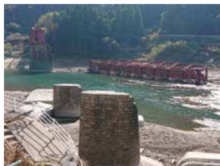
激流により落橋したJR第1橋梁
