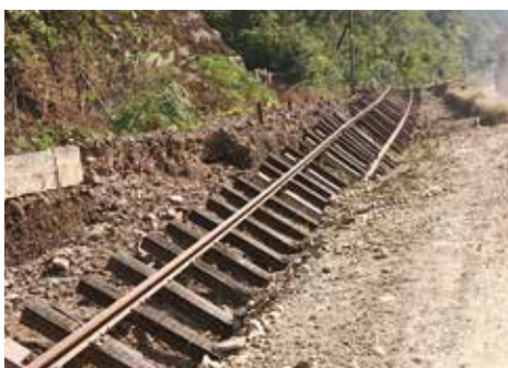
壊滅的状況のJR肥薩線
