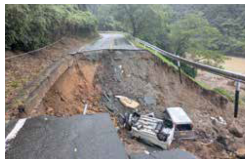
道路が陥没し車2台が転落した県道小川泉線（泉町柿迫草谷）
