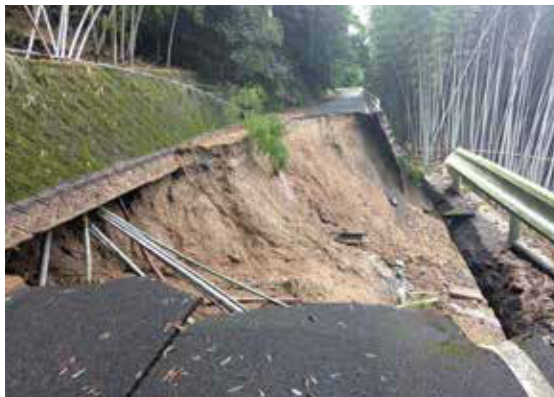
至るところで土砂崩れ、道路陥没により寸断された県道氷川八代線（八代市宮地東町）
